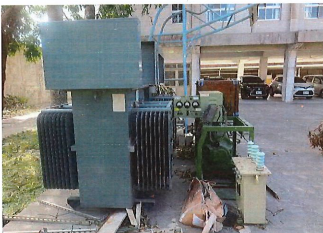
高壓變壓器 3 台
